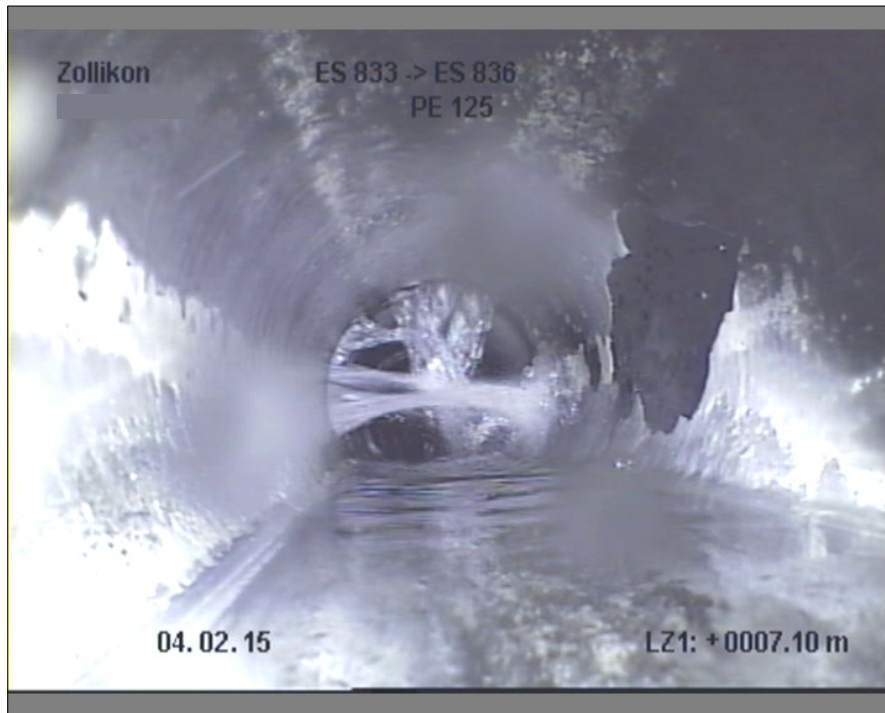
Foto: 1_9A, 00:02:15 7.1m, Infiltration, Wasser spritzt , von 12 bis 12 Uhr
