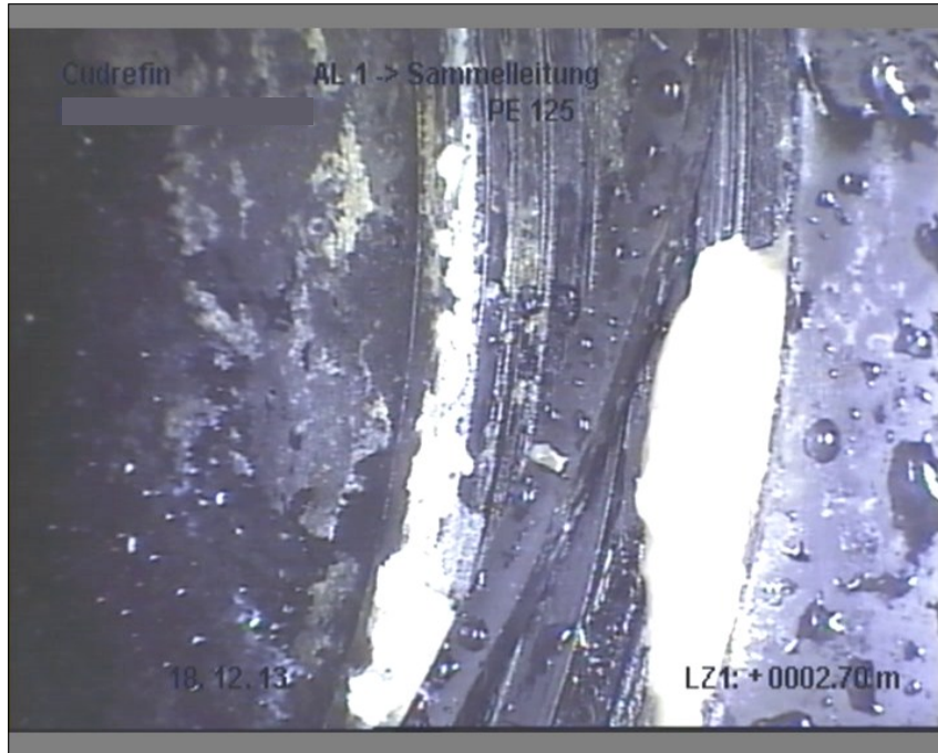
Foto: 2_5A, Datenträger Nr: 181213_1, 00:01:30 2.7m, Reparatur mit grabenlosem Verfahren , von 12 bis 12 Uhr / HESAN
